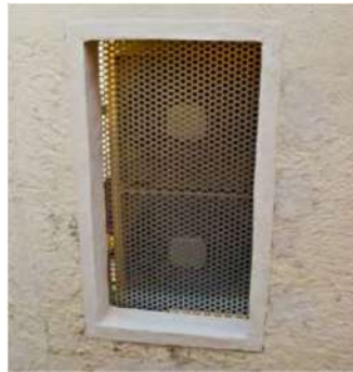
Exemple de traitement pour les échangeurs de climatiseurs.
